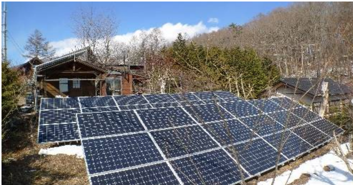
太陽光発電所12KW2012年 DIY太陽光発電キットで製作
